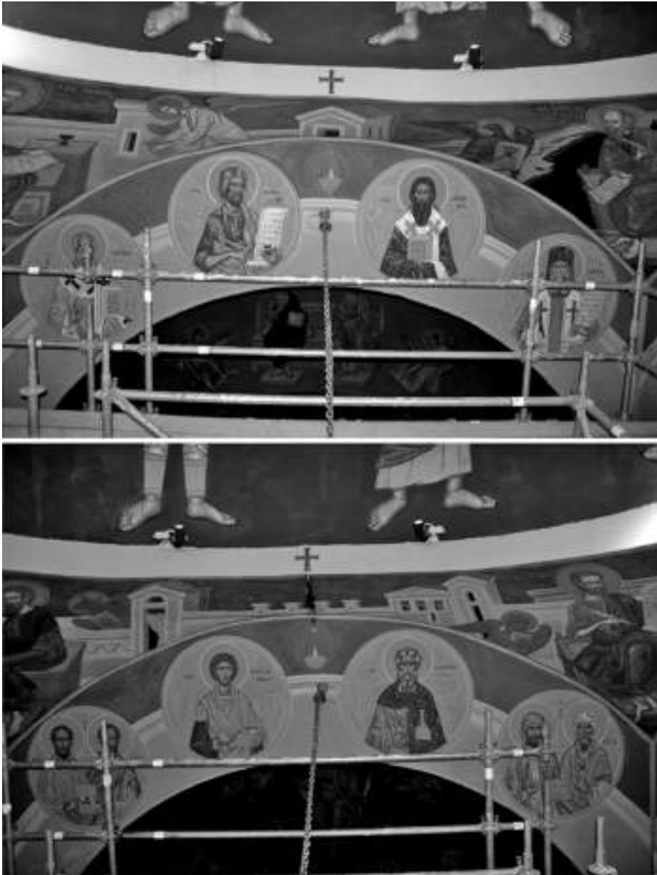
Εικ. 7. Ανατολικό τόξο (επάνω) και δυτικό τόξο (κάτω) μετά την ολοκλήρωση των εργασιών.
