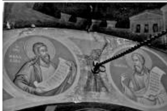
Εικ. 6. Ενδεικτικές φωτογραφίες της γενικότερης καταστάσεως που επικρατούσε στον τρούλο (επάνω) και στα τόξα του τρούλου (κάτω) πριν τη συντήρηση.
